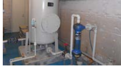
IIF三鷹カードセンター 自動給水装置
